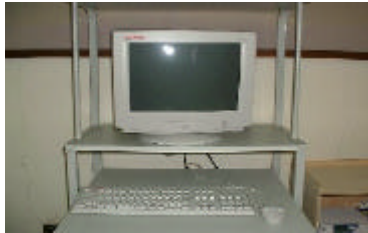
サーバ・モニター
