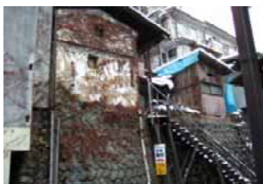
壊れた階段（荒廃したイメージ）
