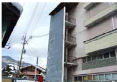
壁の補修が必要
