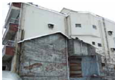
壁の補修が必要
